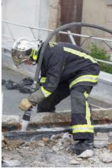
Photo n°3 (@BSPP) : Extinction d'un feu de joint de dilatation entre deux immeubles d'habitation
