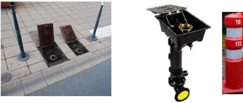
Illustration n°11 : Exemple de bouche d'incendie
